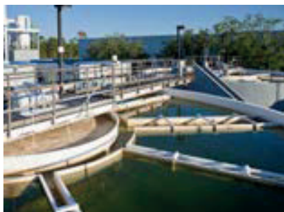
Водоподготовка и очистка
